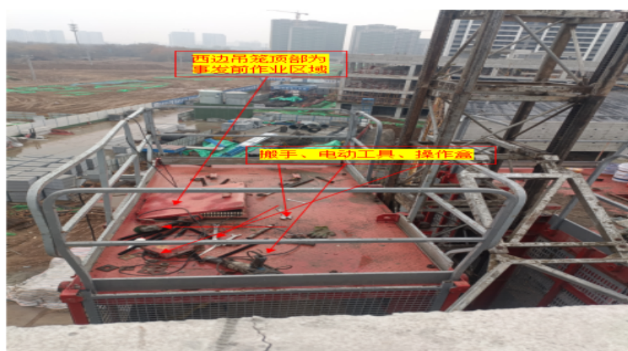
图 6：施工升降机顶部作业区域情况
